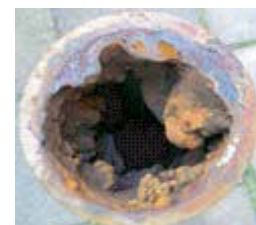
Das Innere der Gussleitung nach ca. 130 Jahren
